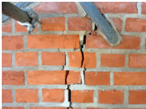
303 Lübeck, Rissbildung am Nordturm der Marienkirche im Bereich der jüngsten Sanierungsfläche (Aufn. 12. Dez. 2012)
