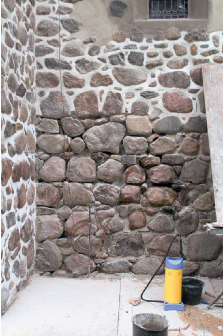
4 Ratekau, Südfassade des Chores der Kirche, untere Mauerhälfte entfugt, vorbereitet zur vollständigen Neuverfugung (Aufn. 20. Juli 2009)
